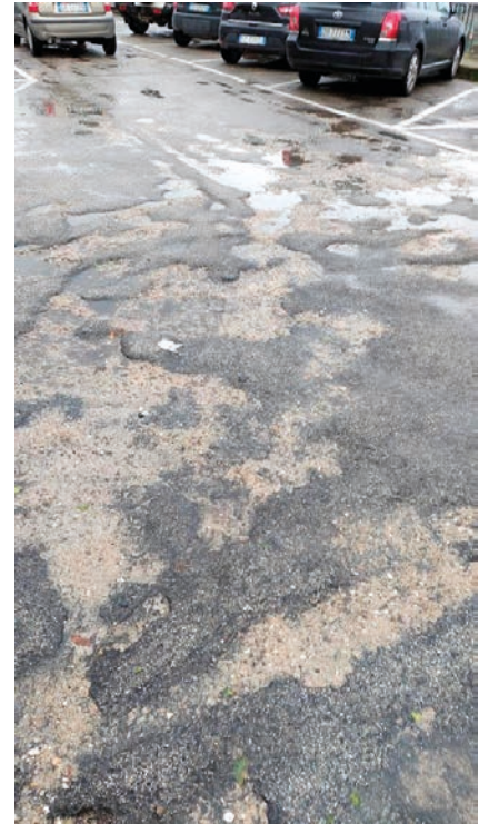
Degrado evidente al parcheggio della Farmacia Comunale
